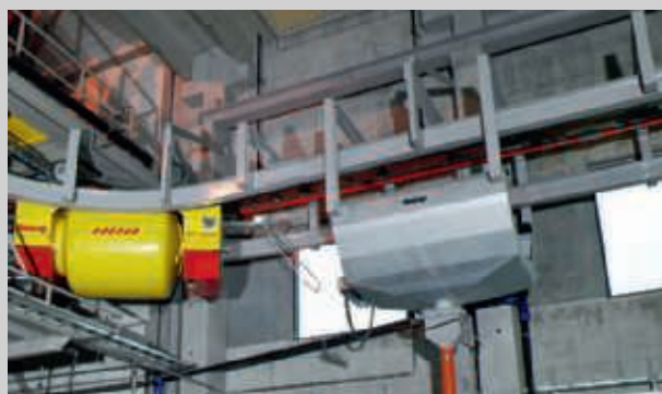
Spulestation til rengøring af 2000 liter duo-speed betontransportvogn.
