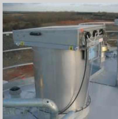
Støvfiltre på silotoppe.
