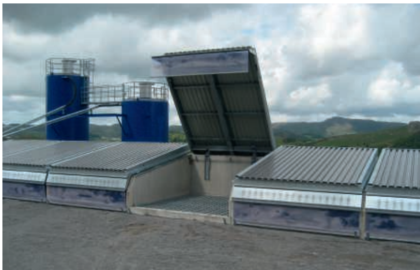
Jordsiloanlæg med hydraulisk styret overdækning.
